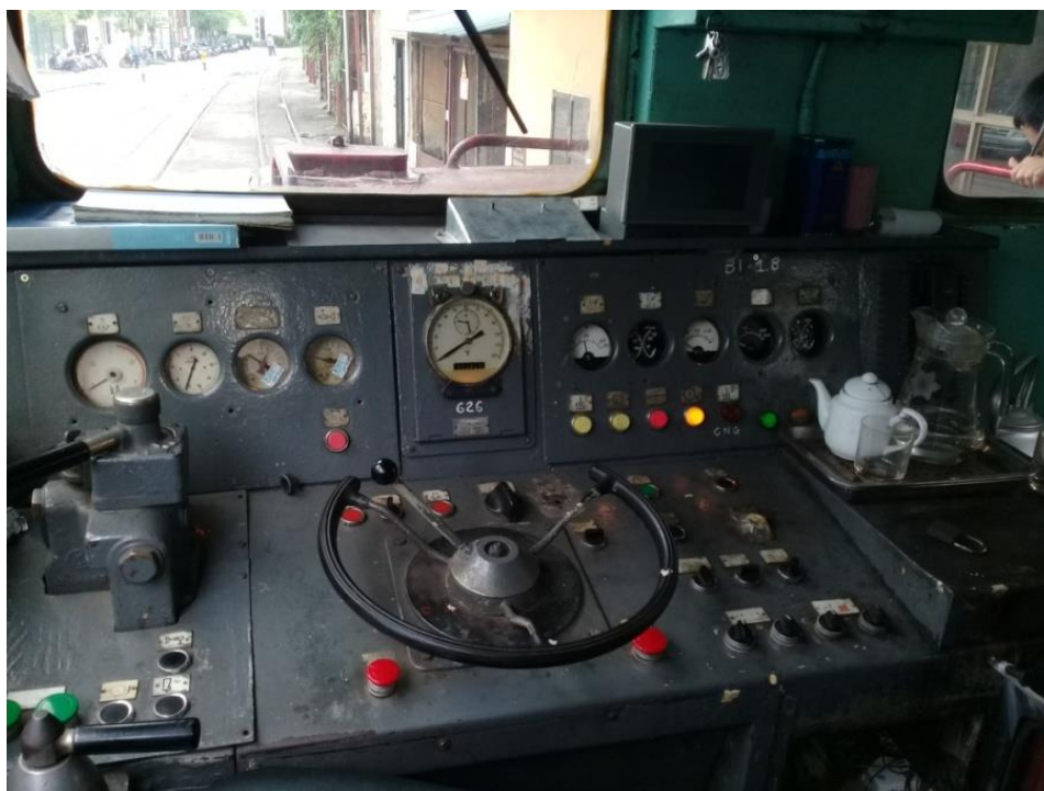
Hình 1.4. Hệ thống điều khiển trên ca bin đầu máy
