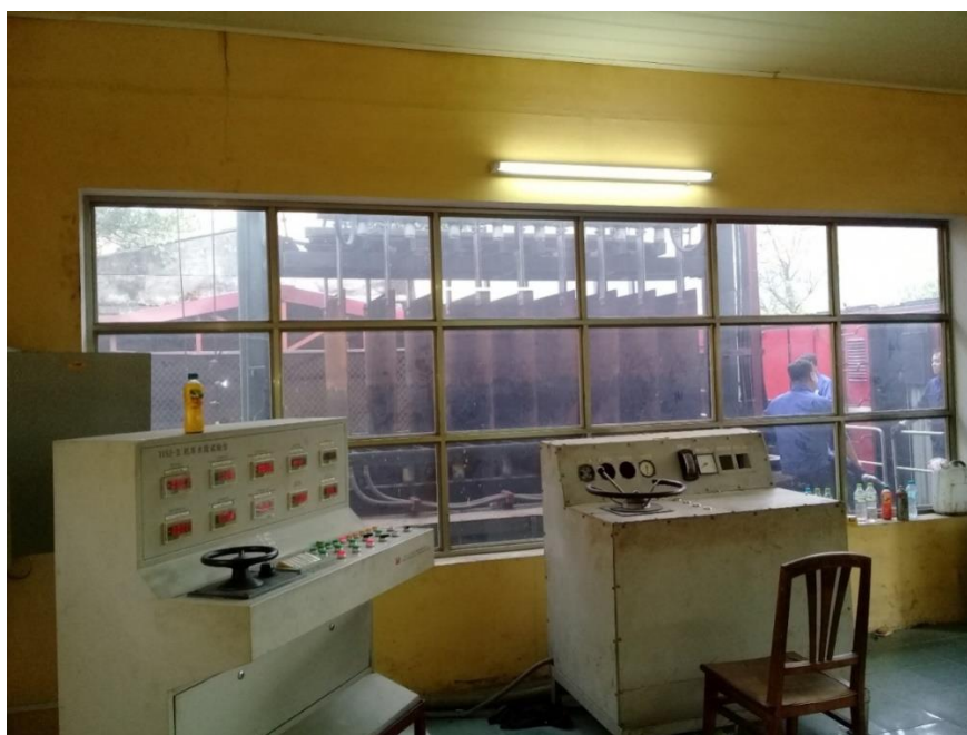
Hình 1.8. Hệ thống điều khiển và hiển thị thông số Bồn thử công suất
